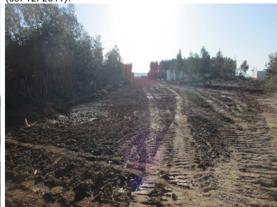
Fotografia 32 - Área prevista para a implantação da via rodoviária de acesso às parcelas 96 a 98 no ponto 18 (05/12/2019).
