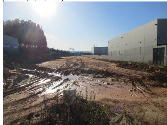
Fotografia 36 - Área prevista para a implantação da via rodoviária de acesso às parcelas 88 a 95 no ponto 20 (05/12/2019).
