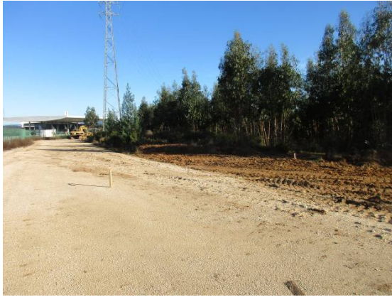
Fotografia 33 - Ponto 18: piquetagem do projeto da via de acesso às parcelas 96 a 98 e área de implantação dos “espaços verdes de enquadramento” previstos no PP do PEC (05/12/2019).
