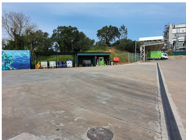
Caleira de drenagem das águas pluviais contaminadas do posto de abastecimento de combustível
